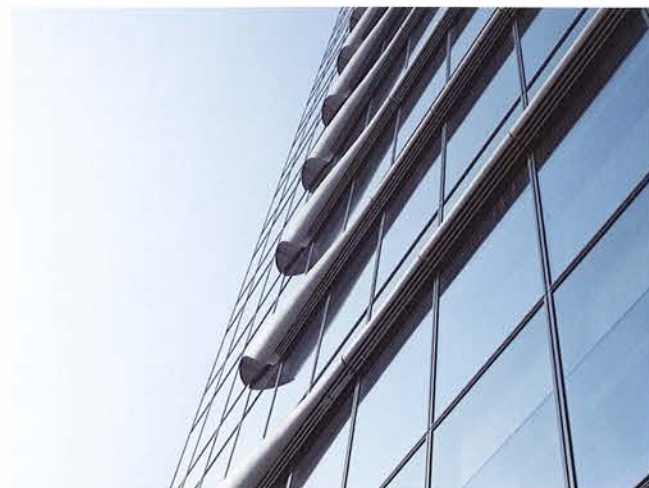
自然換気システム・エアインテーク Natural ventilation system/air intake
