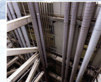
ダクトスペース
