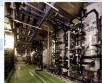
排水処理施設
