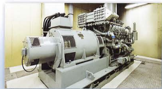
非常用発電機 地下3階機械室には、災害に備えた高出力の非常用発電機を設置しています。
