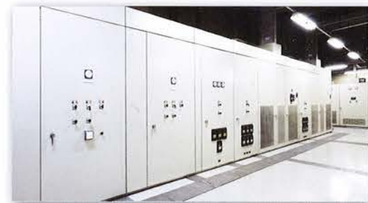
電源供給 22kVループ受電方式により、停電リスクの低い受電を行っています。
