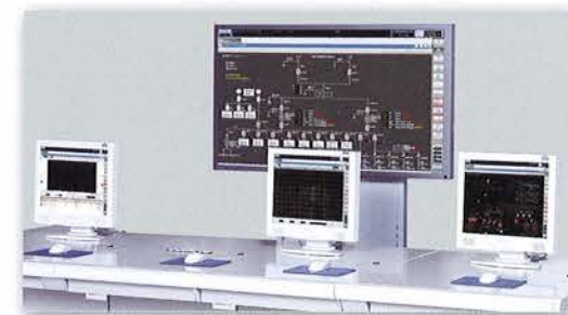
中央監視システム 電気・空調・エレベータ等の運転状況を監視し、執務環境を快適に保ちます。
