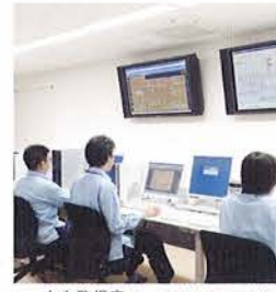
中央監視室 Central Monitoring Office
