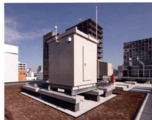
非常用発電機設備
