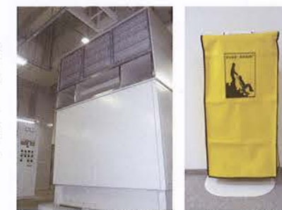
非常用発電機
