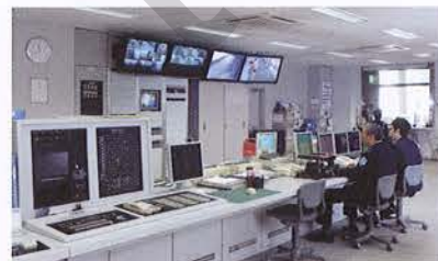
防災センター
