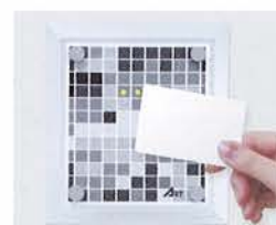
セキュリティ カードリーダー Security card reader
