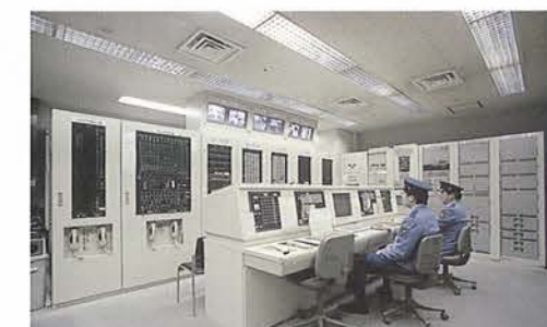
B1 防災センター
