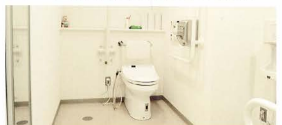
1階共用誰でもトイレ
