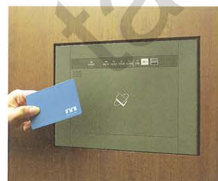
貸室扉カードリーダー Security Card Reader
