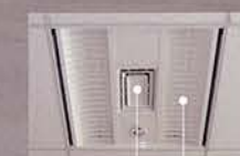
空調吹出口 Air vents 森ビルオリジナル照明器具 Mori Building's unique lighting system
