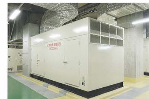
非常用発電機 Emergency Power Generator
