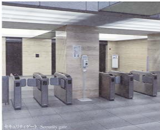
セキュリティゲート Security gate
