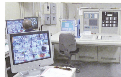
B1F防災センター
