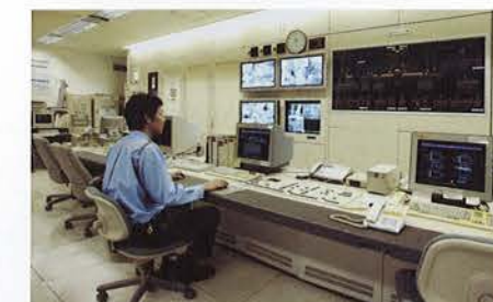
24時間体制の防災センター Emergency center operates round the clock
