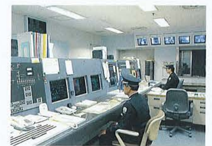
防災センター
